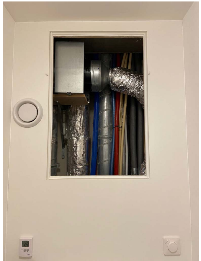
De schacht is hier weer dichtgemaakt, met een opening voor een luik. De geluiddempende flexibele pijp voert naar de ventilator rechtsonder.
