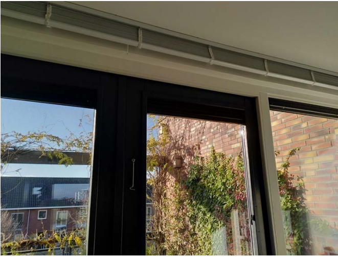
De ventilatieroosters staan permanent dicht
